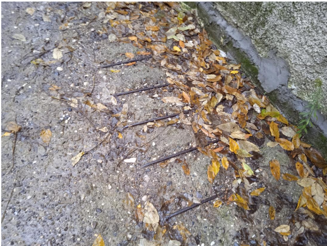
ΦΩΤΟ 3 (Υφιστάμενη κατάσταση) ΑΠΟΣΑΘΡΩΜΕΝΑ ΥΛΙΚΑ - ΔΑΠΕΔΑ
